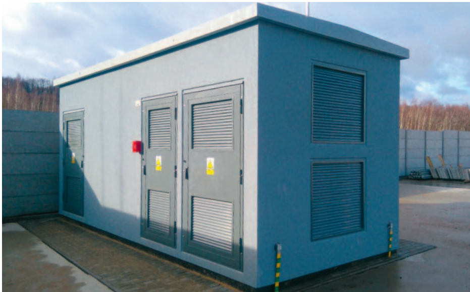
Stacja transformatorowa w obudowie żelbetowej
