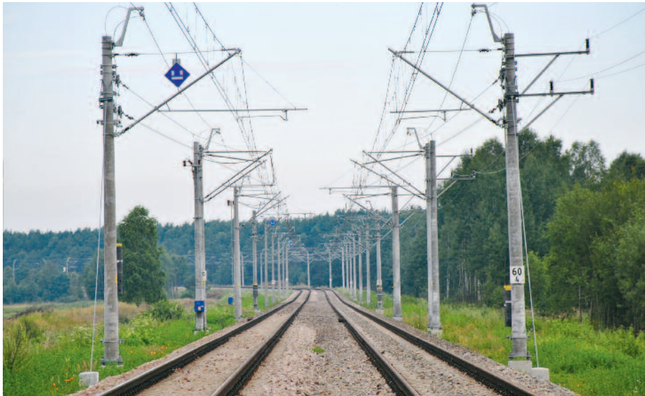
Sieć trakcji kolejowej na słupach ETG
