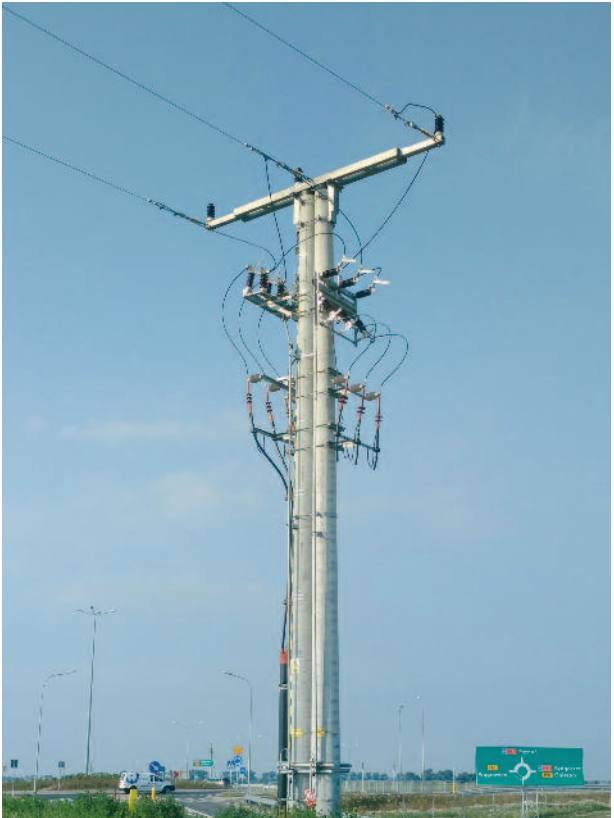
Stanowisko słupowe średniego napięcia
